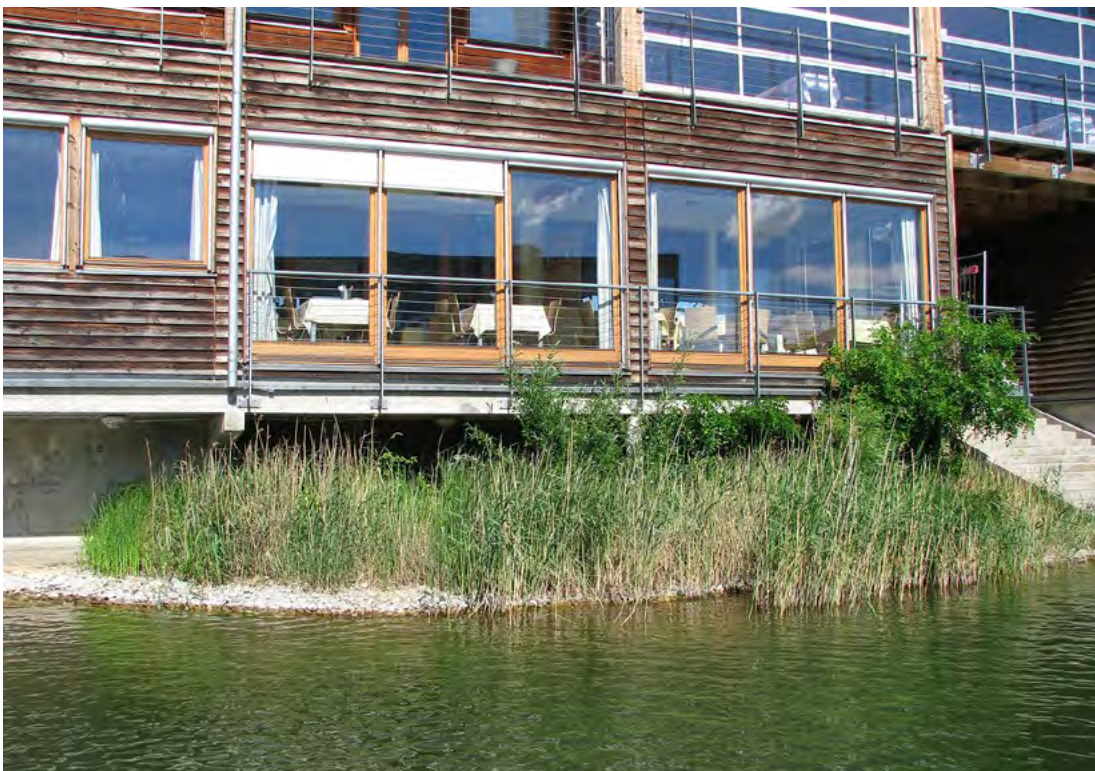
Probestelle 30: Diese Uferstrukturen fallen bei niedrigen Wasserständen trocken und sind nicht funktionsfähig.
